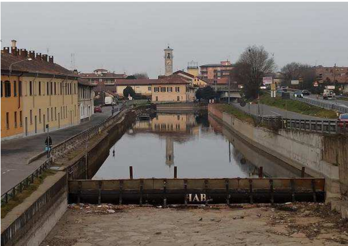
Operazioni di creazione di “bacinizzazione”, sul naviglio Grande, per alimentare solo le derivazioni di un tratto
