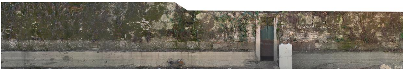
Sponda sinistra tra le progressive 11+400 e 12+500 – muratura verticale con porzione inferiore in calcestruzzo e superiore in mattoni e puddinghe
