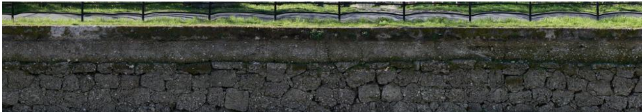
Sponda sinistra tra le progressive 11+100 e 11+400 – muratura semiverticale con porzione inferiore in puddinghe e superiore in calcestruzzo
